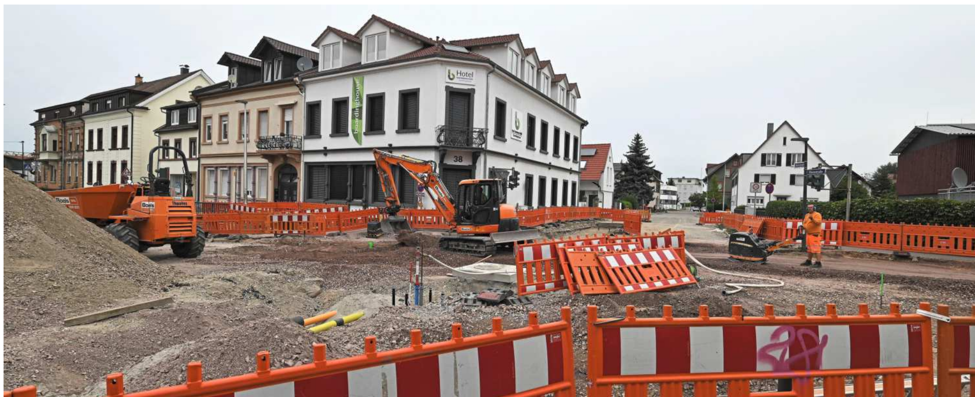
Großbaustelle in der Rheinstraße: Bis Freitag soll der Verkehr aus der Innenstadt in Richtung neue Bundesstraße 3 wieder fließen können. Trotz der Verzögerung wegen des Unfalls geht Wolfgang Schuchter, Abteilungsleiter Tiefbau, davon aus, dass der Kreisel Mitte Dezember wieder befahrbar ist. Fotos: Ulrich Coenen
